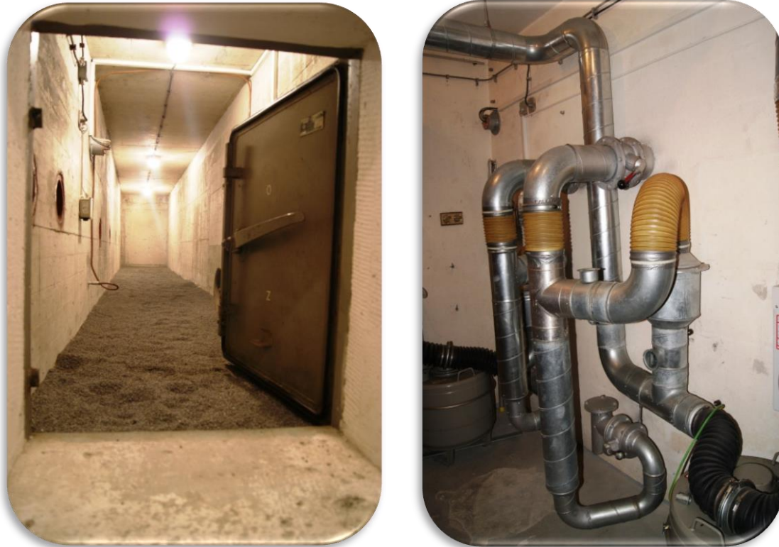
Slika 7 in 8: Leva slika prikazuje filtrirni sistem zračenja, desna pa zračni sistem v zaklonišču na Mojstrski ulici. 26
